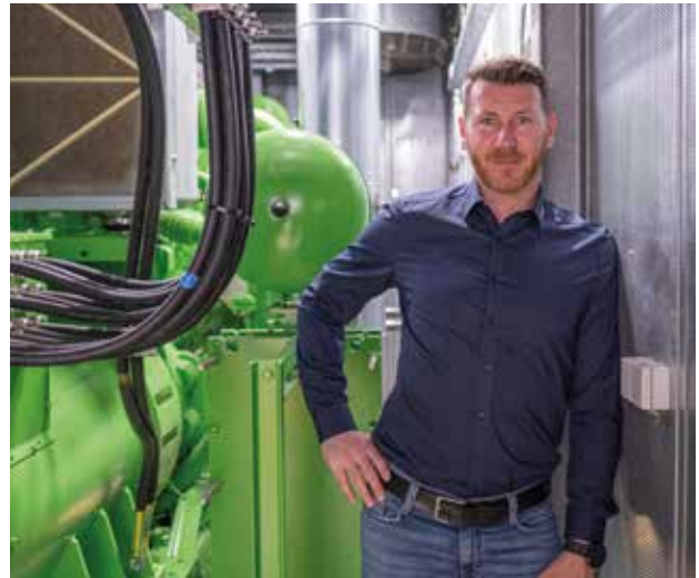
Daniel Steinke, Meisterbereich Wärme
